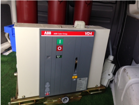
Leistungsschalter von ABB
